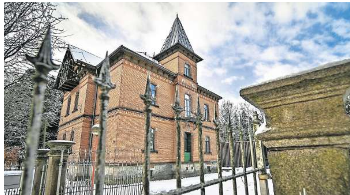
Es ist in die Jahre gekommen und muss dringend saniert werden: das Jochen-Klepper-Haus in Selb-Plößberg, das dem Dekanat Selb gehört.
